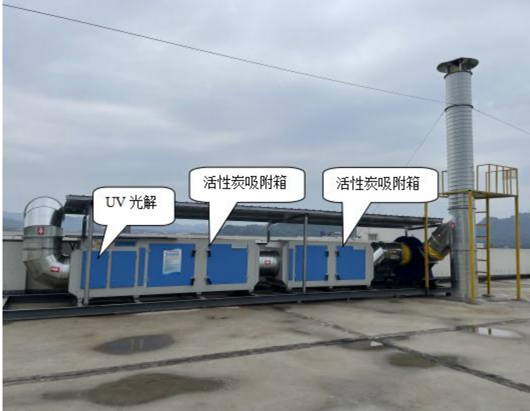
注塑废气处理装置
