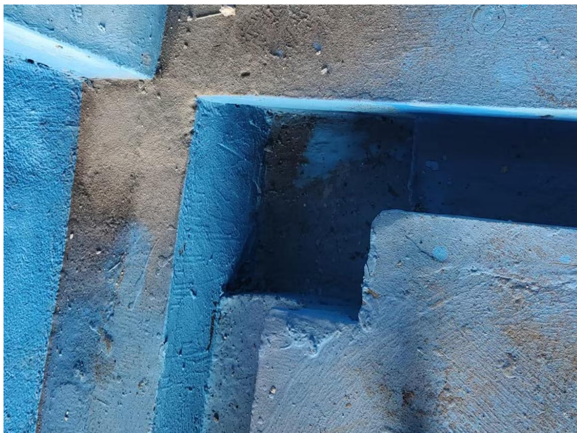
危废暂存间截流沟和收集井
