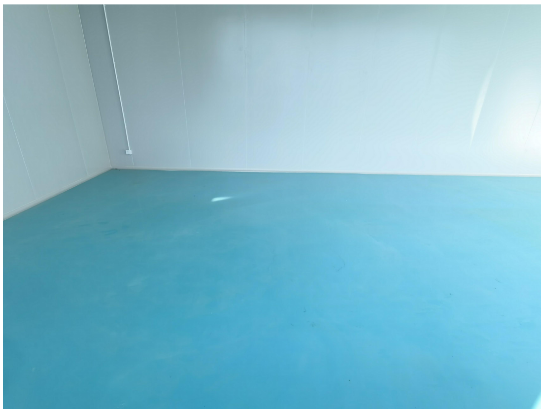
一般工业固废暂存间内部
