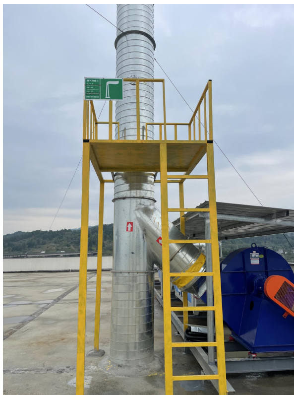
废气采样平台
