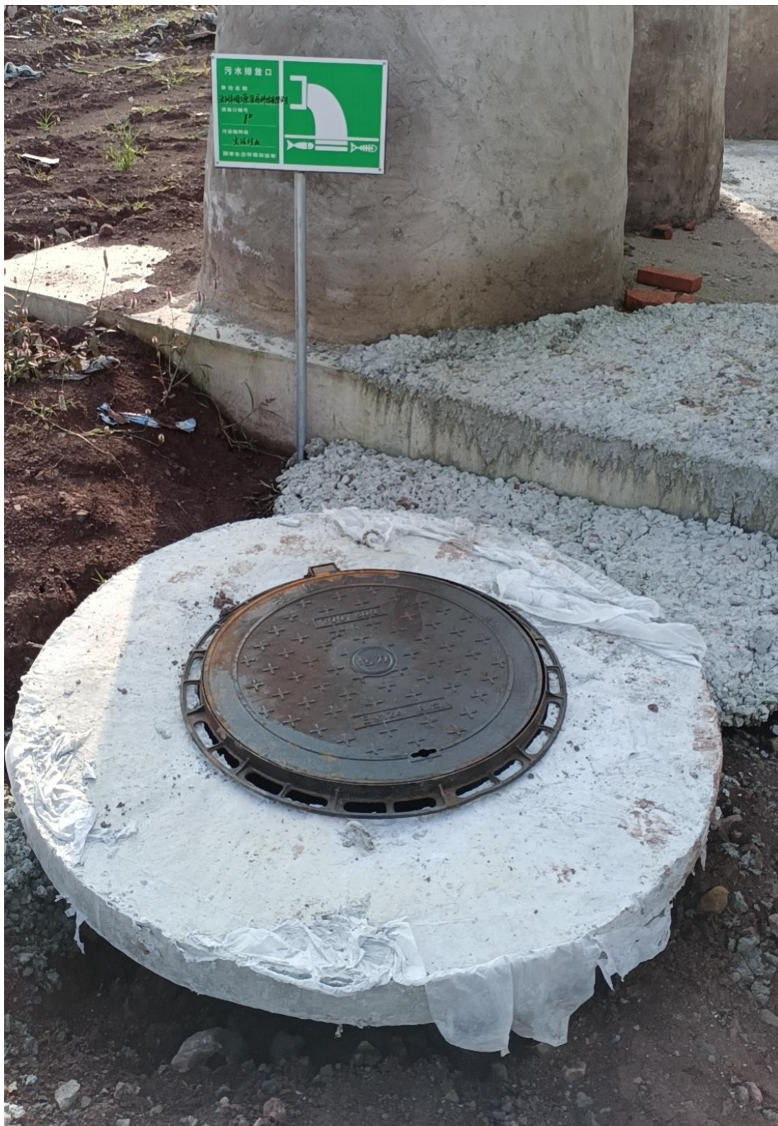
项目废水排放口及排放口标志牌
