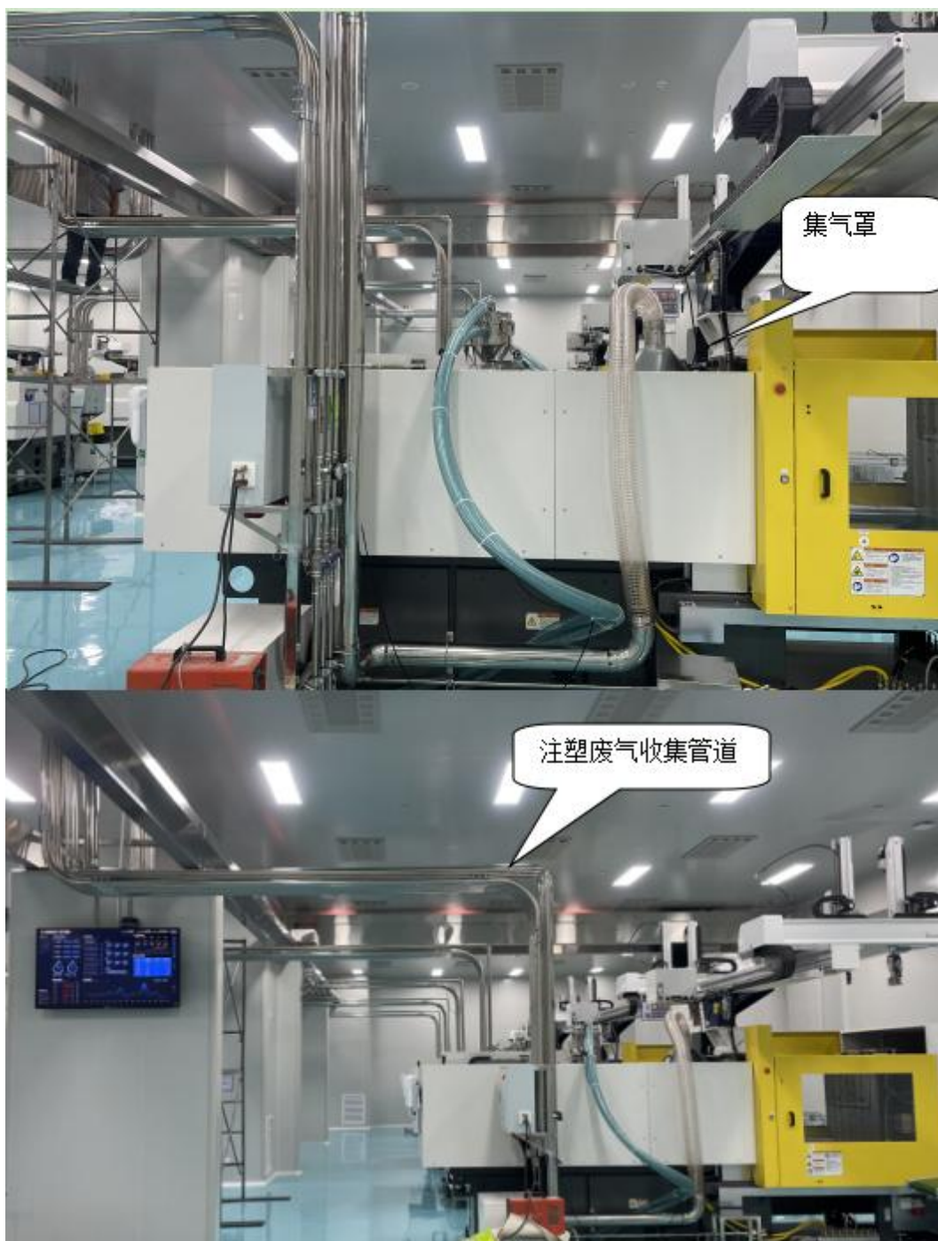
注塑废气车间收集系统
